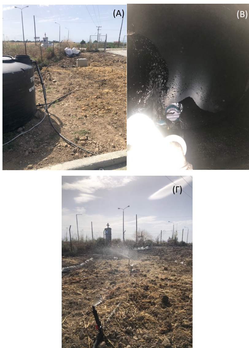
Εικόνα 6. Εικόνες από την εγκατάσταση (Α) της δεξαμενής αποθήκευσης των υγρων αποβλήτων, (Β) της υποβρύχιας αντλίας και (Γ) του συστήματος ψεκασμού των αποβλήτων στην βιοκλίνη με μπεκ.
